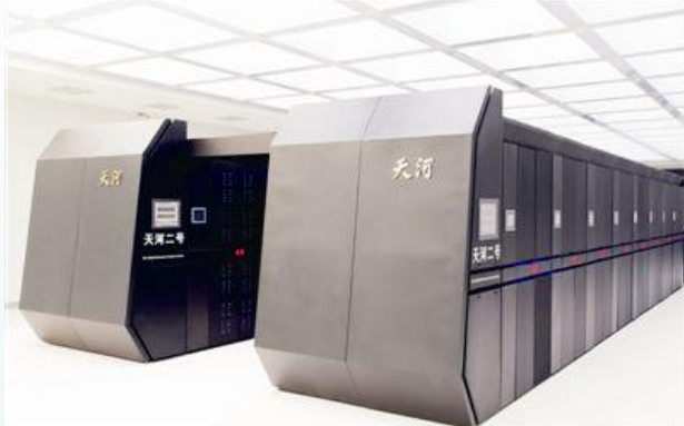
吕梁超算中心+组内服务器
