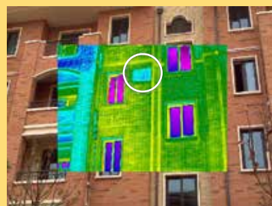
外墙维修后未填实，该处容易渗水
